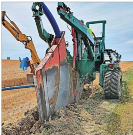
Mit einem zwei Meter hohen Pflugschwert wurde vor zwei Jahren eine neue Leitung zwischen Ruckasing und Mühlham eingezogen, um die beiden Teilnetze der Stadtwerke zu verbinden und die Versorgungssicherheit zu erhöhen. – Foto: Seifl
