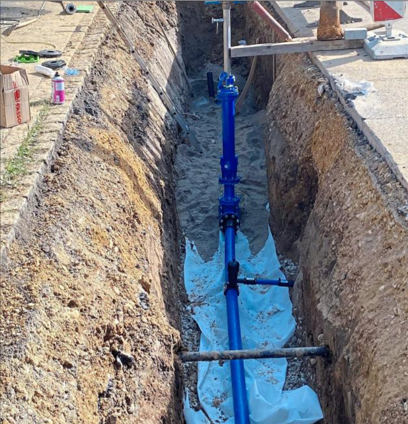
Viel Geld, das in den Böden verbuddelt ist, um die Haushalte mit Trinkwasser zu versorgen: Das Leitungsnetz muss stets einwandfrei sein.
