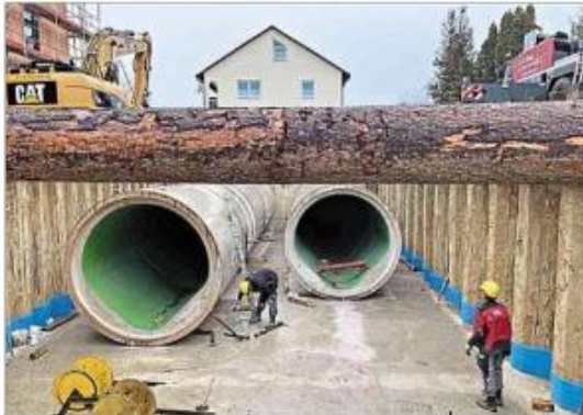
Nach und nach werden die Rohrstücke zu langen Röhren verbunden. Die Besonderheit: Die Verstärkung der Spundwände erfolgte hier mittels Baumstämmen in nachhaltiger Bauweise. Die Stämme können wiederverwendet werden.
